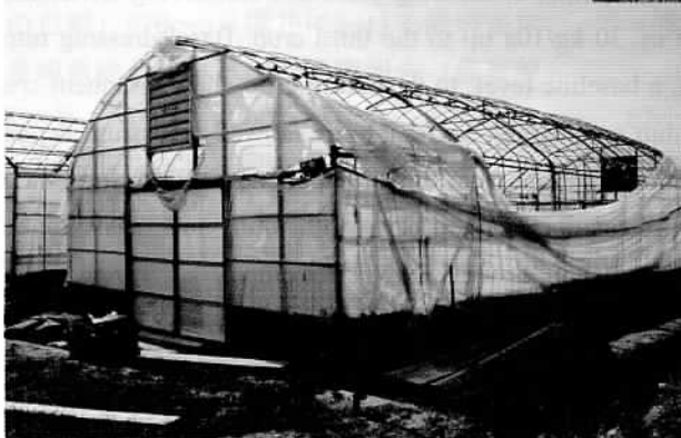
上：ビニール被害の状況 天井部分が全面剥がれている。
