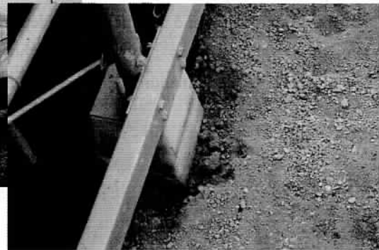
上：基礎が動きやや浮いている状況
