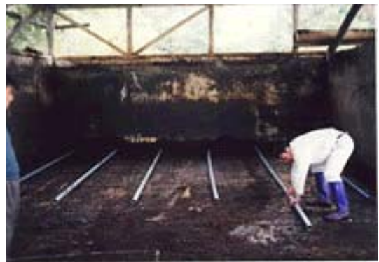
写真 1.3.20 底面に設置した通気管
