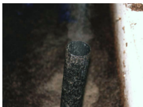
写真1.2.12 通気管からの蒸散
