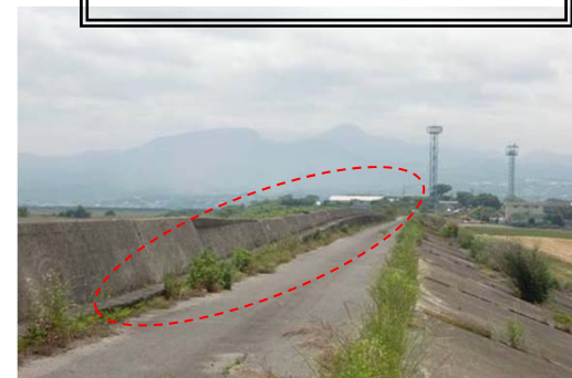
堤体全体が沈下。最大50cm程度の沈下を確認。
