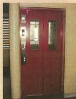
かご内を見通すことができる構造の窓が設置された扉
