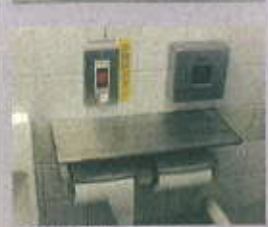
非常通報装置
