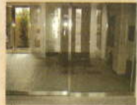
オートロックシステムを設置した集合玄関扉
