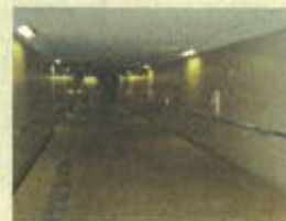
地下道に連続的に設置された防犯設備
