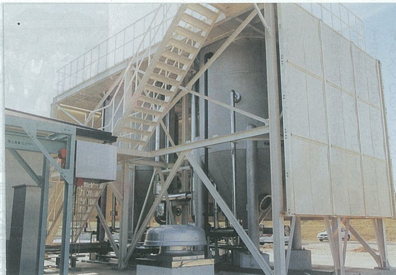
砂ろ過タンク
