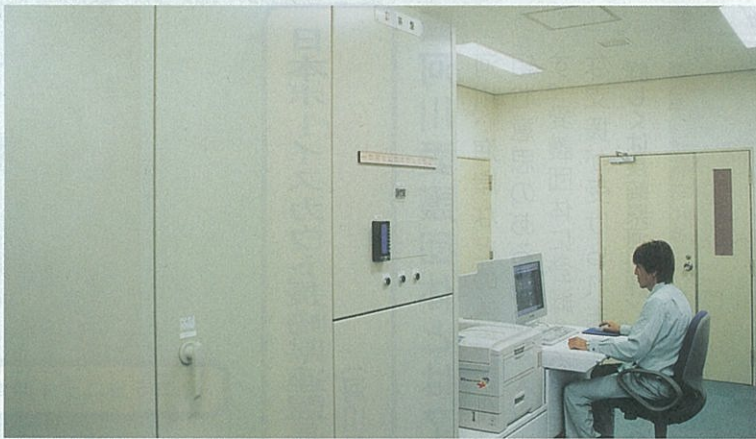
監視制御室(管理棟)
