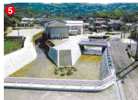
5 工事名 江川河川改修工事 施工者/技術者 竹下建設工業(株)／宮崎 正吾 工事内容 川を広げ洪水を防止するための工事です
