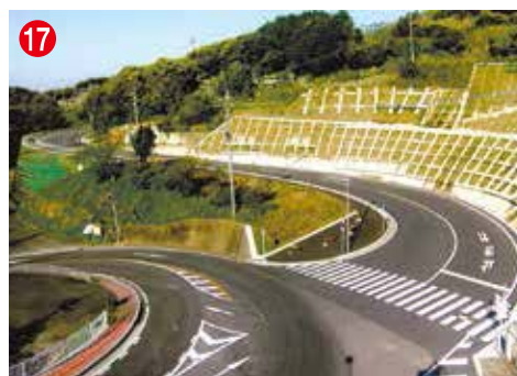
17 工事名 主要地方道勝本石田線道路改良工事 (1工区) 施工者/技術者 壱岐土木工業(株)／永田 貴文 工事内容 道路を広くするための工事です
