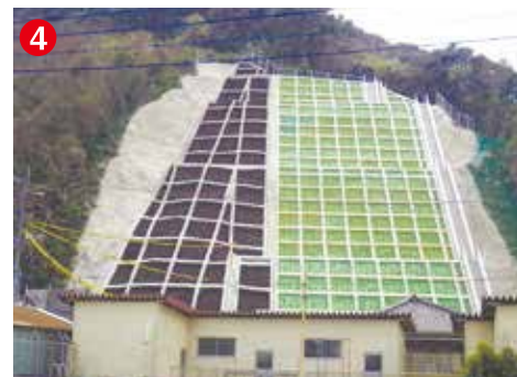
4 工事名 真浦(1)地区急傾斜地崩壊対策工事 施工者/技術者 武藤建設(株)／福島 賢治 工事内容 斜面の崩壊を防止する工事です
