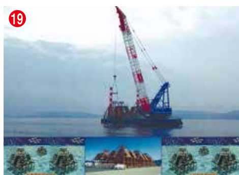
19 工事名 長崎南地区水産環境整備工事 (大村湾工区) 施工者/技術者 大石建設(株)／末永 茂則 工事内容 豊かな漁場をつくる工事です
