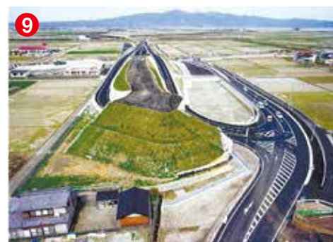
9 工事名 一般国道251号道路改良工事(舗装1工区) 施工者/技術者 吉川建設(株)／片山 大司 工事内容 自動車専用道路の舗装工事です
