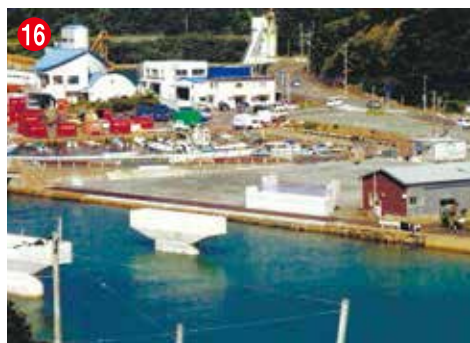
16 工事名 一般国道384号道路改良工事 (仮称)新相河橋 P2・A2) 施工者/技術者 (株)坂本組／法村 文孝 工事内容 橋の橋台と橋脚を新設する工事です
