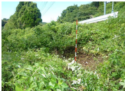
法面崩壊（盛土）
