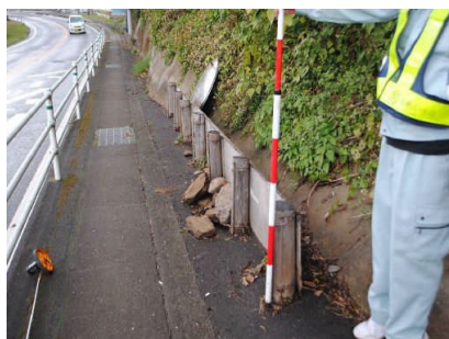
のり尻部の小落石（兆候）
