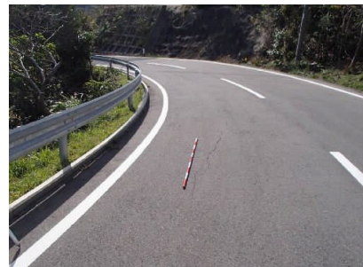
舗装のクラック
