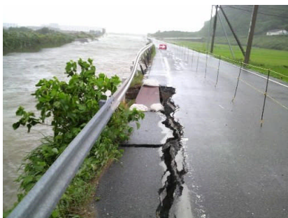
擁壁 (崩壊) ((主)厳原豆酸美津島線 H22.8 発生)
