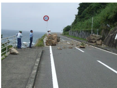
落石・崩壊 ((県)高島線 H22.6 発生)
