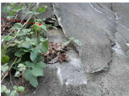
吹付面上のクラック
