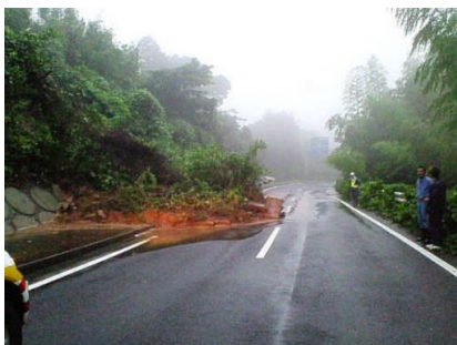
落石・崩壊 ((主)栗木吉井線 H21.7 発生)
