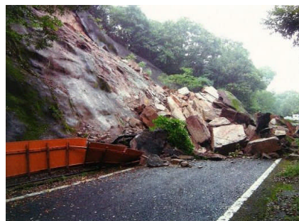
落石・崩壊 ((県)扇山公園線 H24.7 発生)
