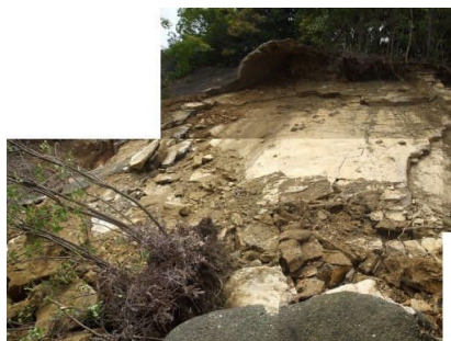
落石・崩壊 ((国)206号 H22.4 発生)
