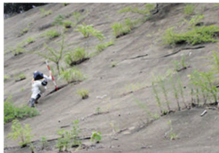
道路防災総点検（盛土崩壊箇所）
