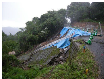
擁壁 (崩壊) ((県)七釜西彼線 H23.7 発生)
