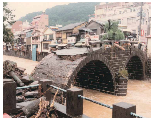
中島川の氾濫により一部流失した国指定重要文化財眼鏡橋
