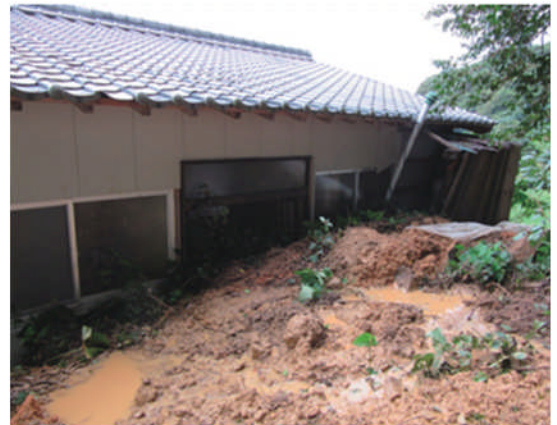
人家裏の斜面が崩壊（平成29年 五島市）
