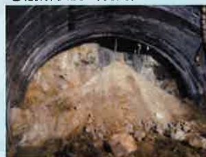
③崩落状況 (坑内)
