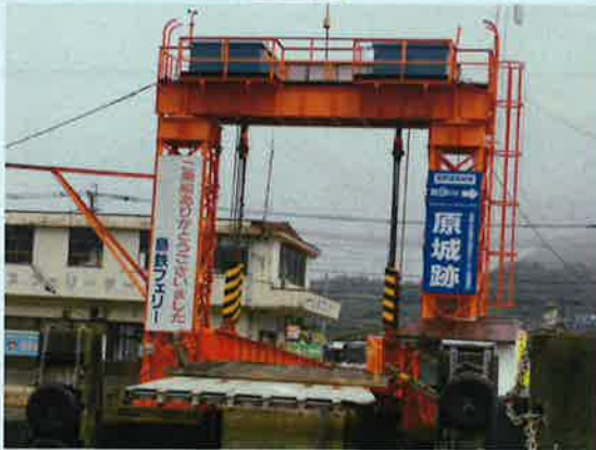
ターミナルビル、可動橋の老朽化状況
