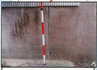
民家壁面の亀裂
