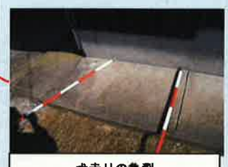
犬走りの亀裂
