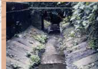
当時造られた下水路(ししとき川下水路と地獄川下水路、3面石張りで、天川で汚水漏れを防止している)
