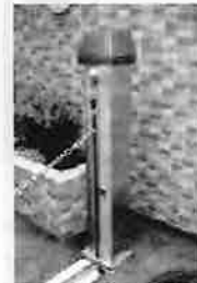
駐車場出入口に設置されたオートバリカー
