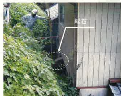
写真: 保全人家裏に落下した転石 (平成20年5月発生)
