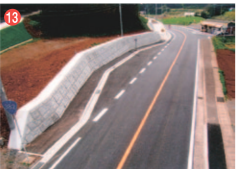
13 工事名 一般国道382号人によさしい道づくり工事 施工者/技術者 (株)広瀬組/門谷 光修 工事内容 道路の見通しを良くする工事です。
