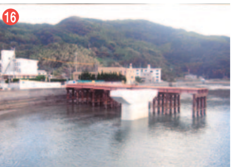
16 工事名 一般国道202号橋梁整備工事 (雪川橋下部工P2・A2) 施工者/技術者 黒瀬・上滝JV/松井 国宏 工事内容 橋の橋台、橋脚を新設する工事です。
