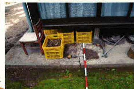
犬走りの亀裂
