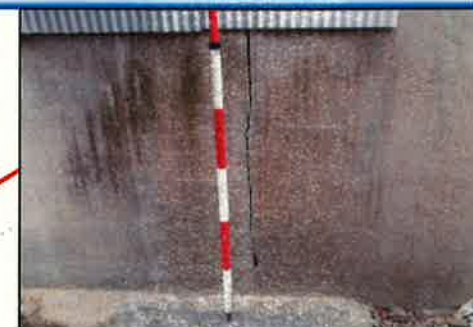
民家壁面の亀裂
