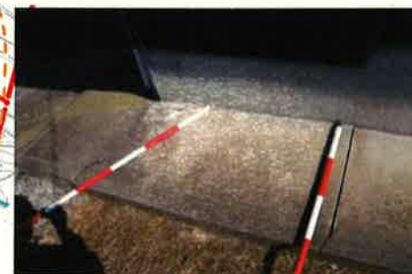
犬走りの亀裂
