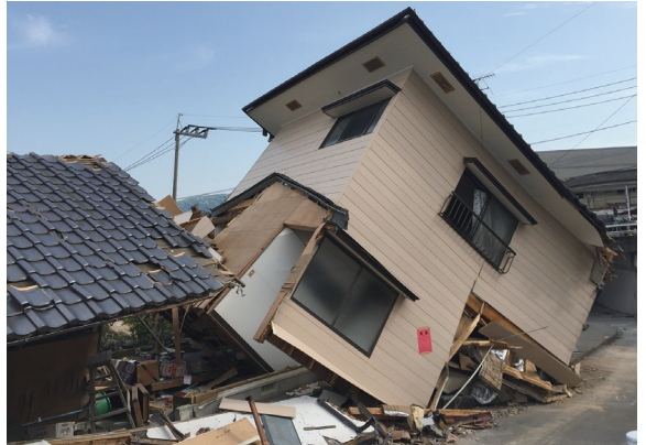
H28熊本地震により倒壊した住宅 (熊本県益城町) (平成28年4月長崎県被災建築物応急危険度判定チーム撮影)
