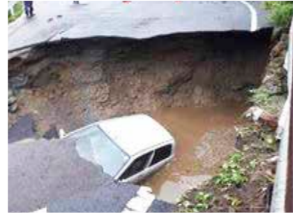
令和2年9月12日の大雨により被災した野母崎宿線(長崎市大崎町)
