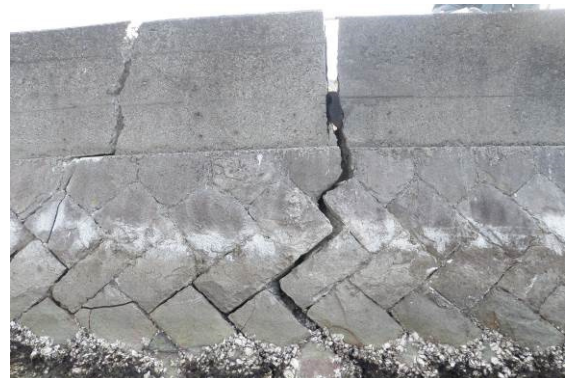
海岸保全施設の老朽化状況（鳥加海岸）
