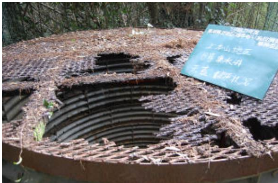
地すべり防止施設（集水井）の老朽化状況 （上本山地区）
