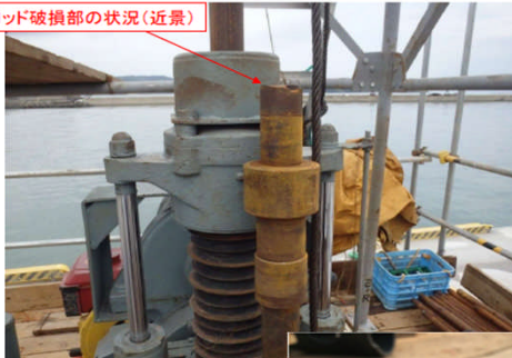
ロッド破損部の状況(近景)
