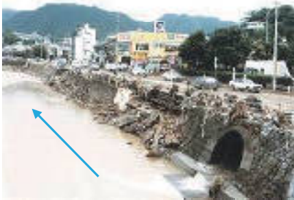
長崎大水害（S57.7.23）の被災状況
