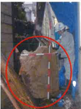
平成31年2月15日 岩塊崩落(節理に沿った割れ始め状況)
