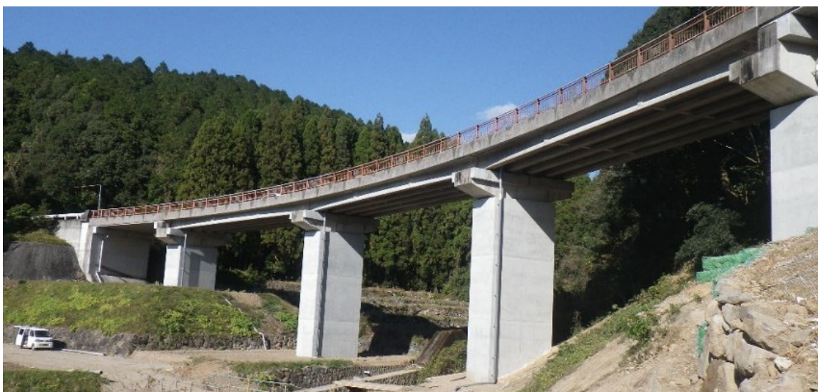
大村レインボーロード地区の耐震補強工(大村市) 橋脚補強工(コンクリート巻立工)+落橋防止工(縁端拡幅工など)
