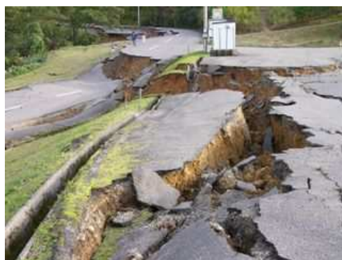
写 3-13 排水施設の変状の例
