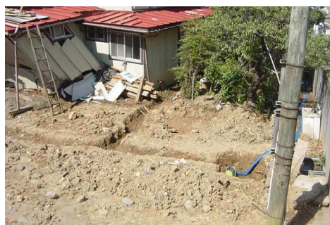
(b) 地震により湧水が出た箇所
