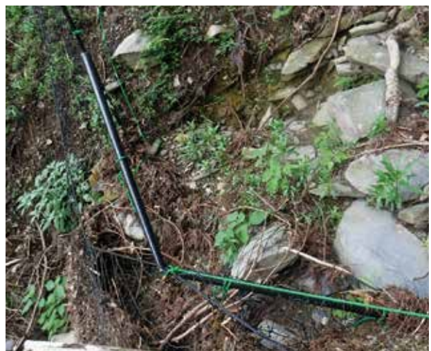
土砂堆積・支柱折損
