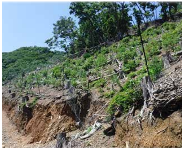
法肩が崩壊して機能低下
