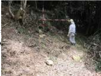
NO,30付近_石積崩壊・落石状況
