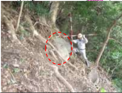
NO,50付近_転石状況
