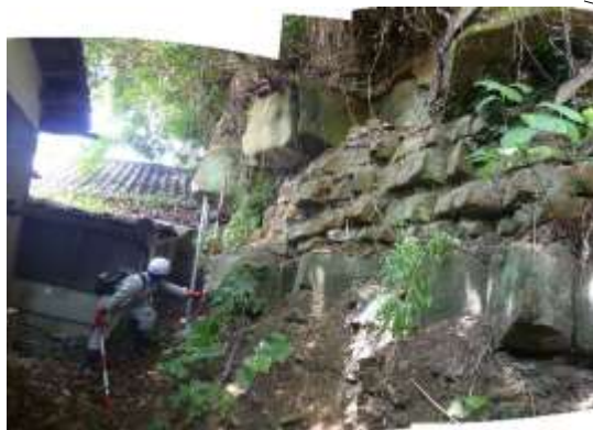
家屋裏の亀裂が発達した斜面
