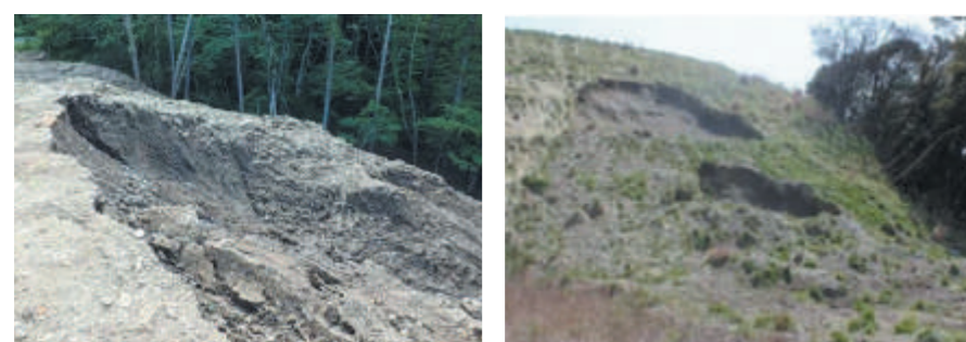
<危険な盛土、盛土移動のイメージ>
