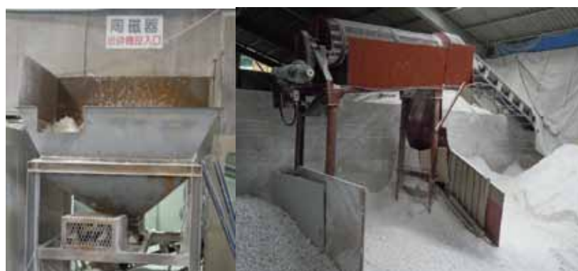
写真(左:石膏粉砕機、右:石膏粒の篩分け)
