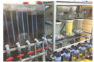
■ リン回収装置 (移設後)
