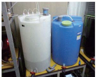
処理水槽(左)・脱着槽(右)
