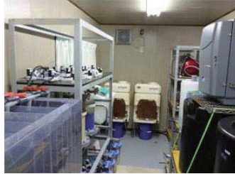
システム全体(入口から)
