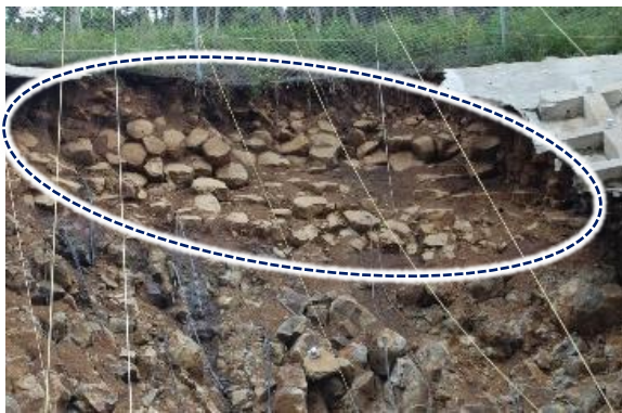
図 9 滑落崖上端に分布する玄武岩崩積土
