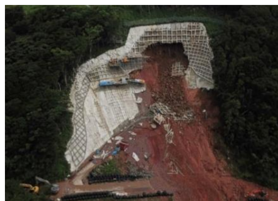
図3 2021 年（令和 3 年）崩壊・崩落直後の状況
