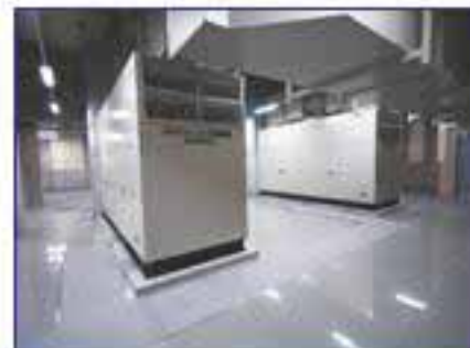
非常用発電装置 (栃木県)
