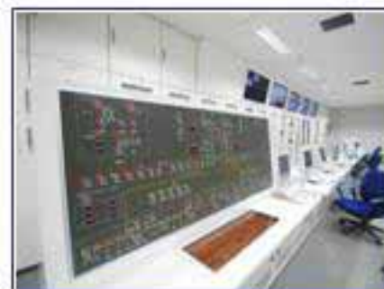
中央管理室 (栃木県)
