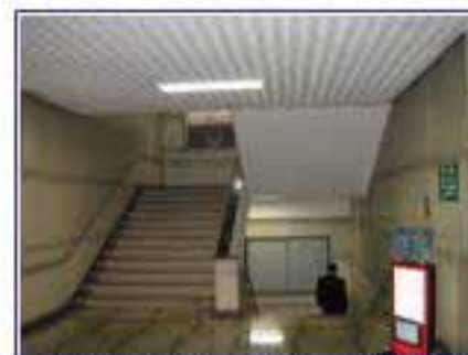
階段と廊下を区画する防火扉が未設置
