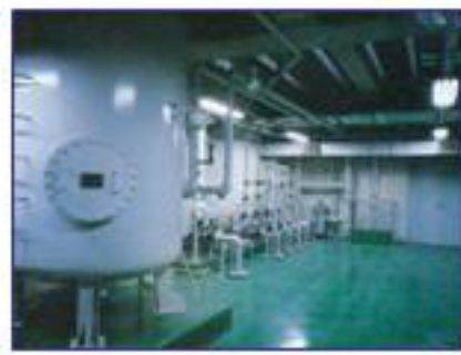
雨水利用設備 (鹿児島県)
