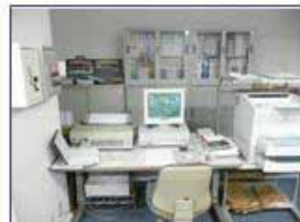
空調管理室 (空調設備のみの管理)
