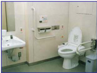
障害者用トイレ (群馬県)
