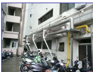
屋外に露出した配管
