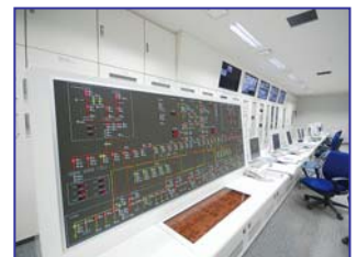
中央管理室 (栃木県)
