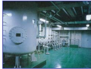
雨水利用設備 (鹿児島県)
