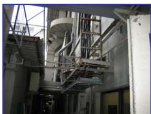
屋外に露出した配線
