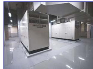
非常用発電装置 (栃木県)
