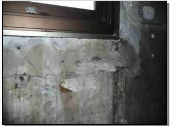
エレベーター機械室内のひび割れ
