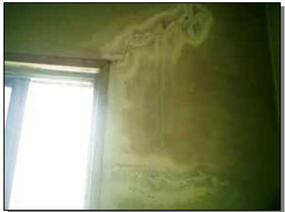
庁舎内壁からの雨漏り
