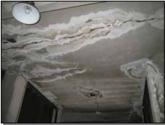
時計塔内天井のひび割れ
