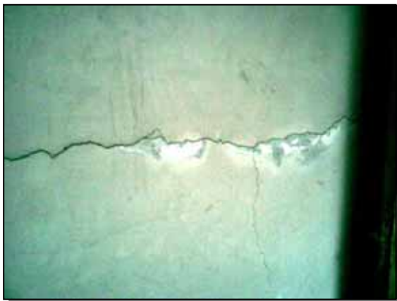
庁舎内壁のひび割れ
