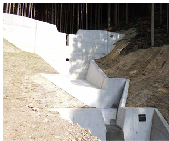
木場地区奥地保安林保全緊急対策工事 (谷止工・流路工)
