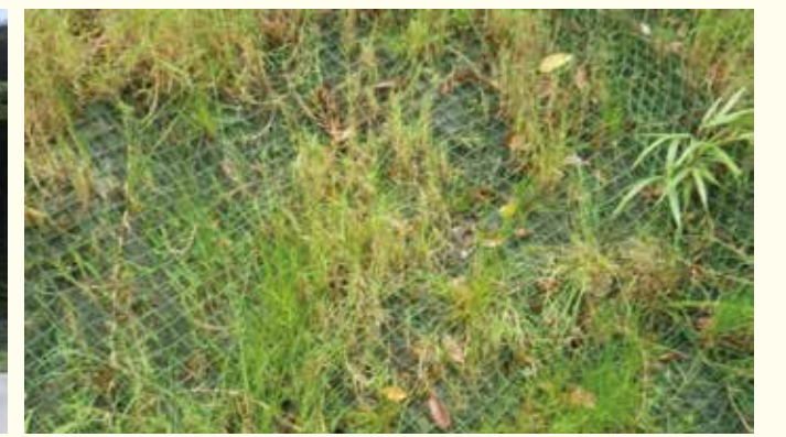
シカやイノシシの食害対策として獣害ネットを施工した。(意見③)
