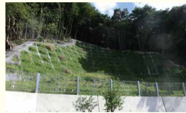
法枠内部に育苗棚を設け野芝を播種して緑化を図り、法枠をできる限り隠すよう工夫した。(意見②)
