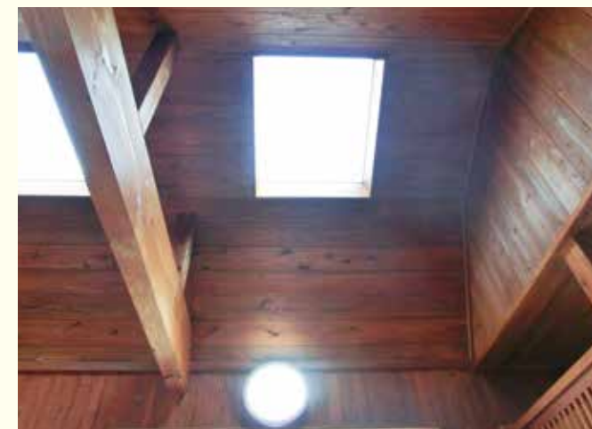
明り窓を設置したことで、管理費が削減された。（意見②）
