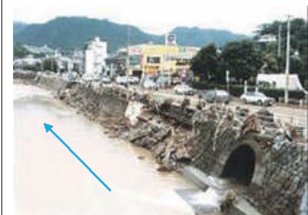
長崎大水害（S57.7.23）の被災状況
