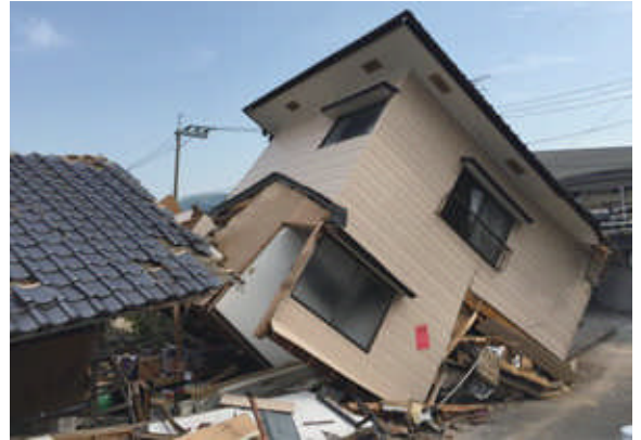
H28熊本地震により倒壊した住宅 (熊本県益城町) (平成28年4月長崎県被災建築物応急危険度判定チーム撮影)
