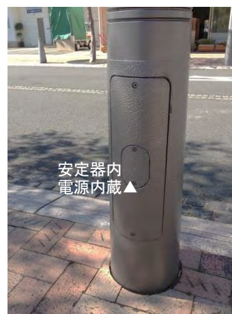
▲イベント用電源設備の例(宮崎・日向市) イベント開催に必要な電源設備を街路灯安定器内にあらかじめ設置しています。
