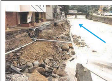
長崎大水害 (S57.7.23) の被災状況
