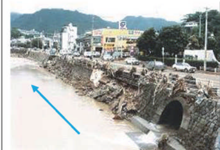
長崎大水害 (S57.7.23) の被災状況
