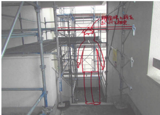
棚足場に頭をぶつけて被災
