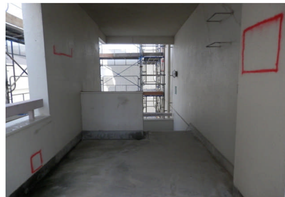
改善策(作業計画を見直し、2つある階段の一方の階段を学校関係者の通路として解放)
