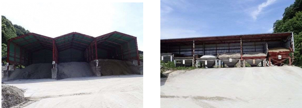
写真-5.1 実機試験を実施した生コン工場の貯蔵設備（砕砂は予備サイロ等を利用）
