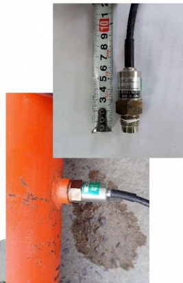
圧力センサー設置上状況
