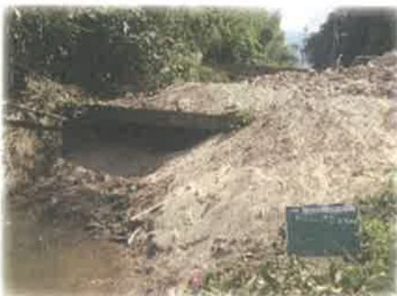
土砂が堆積した水路
