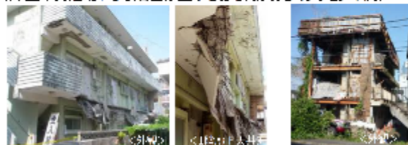
2階の廊下部分が崩落した事例
