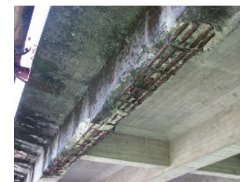
橋梁損傷事例
