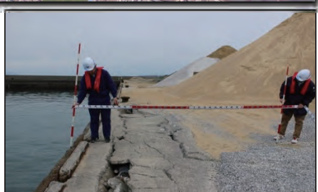
・施設老朽化状況写真 舗装工ひび割れ状況
