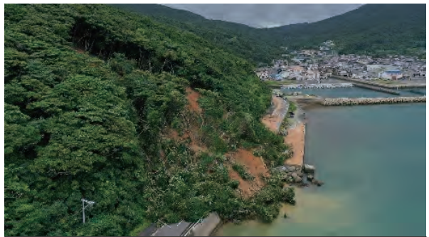
(一)青方港魚目線 道路被災状況 令和元年7月20日 新上五島町
