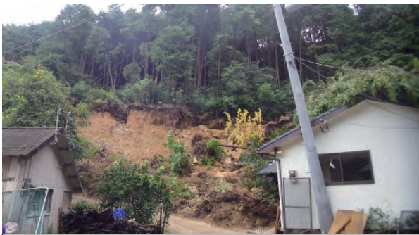
山腹崩壊被災状況 令和元年8月27日発生 佐世保市下歌ヶ浦地区
