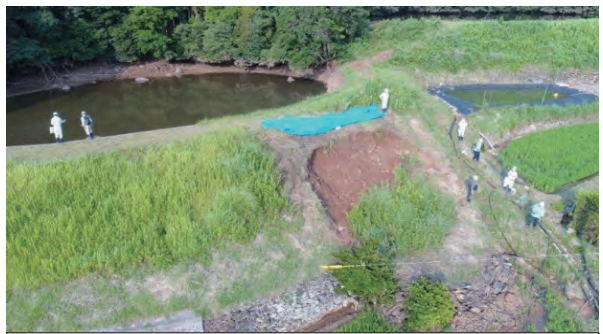
ため池外堤法面の崩壊状況 平成30年7月 佐世保市
