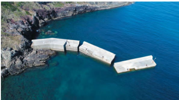
木場漁港 防波堤被災状況 令和元年9月 台風17号 佐世保市
